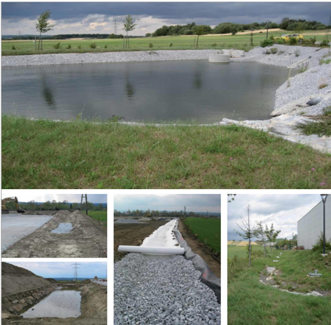
Abbildung 27: Speicherteich, Versickerungsmuldenrigol (Bild unten Mitte) und Versickerungsmulde (Bild unten rechts)
