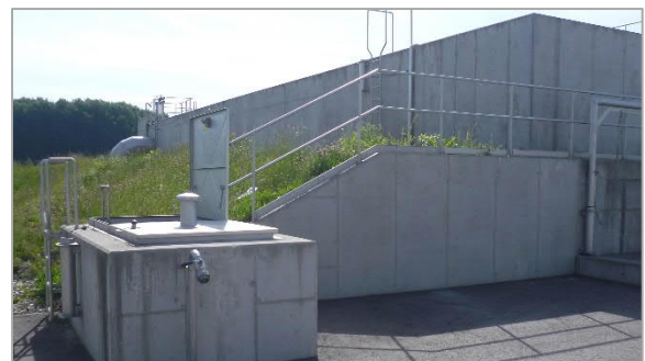
Abbildung 33: Drosselschieberschacht, im Hintergrund das Rückhaltebecken
